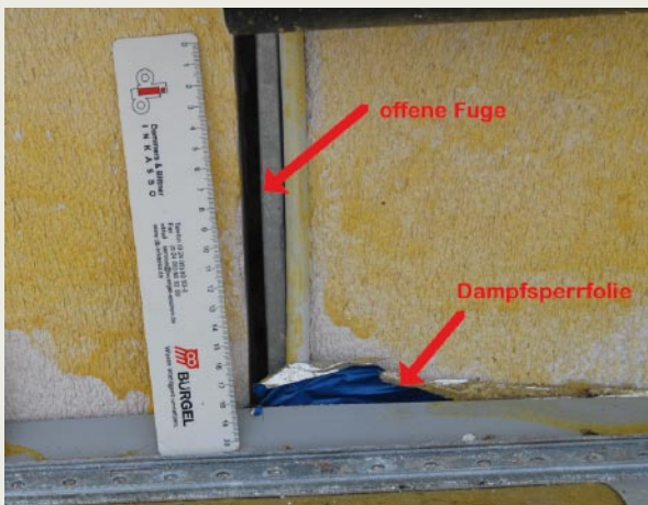
Am Anschluss des Mauerwerks konnten offene Fugen festgestellt werden. Zudem zeigte sich dort auch eine mangelhafte Verklebung der Dampfsperre.
