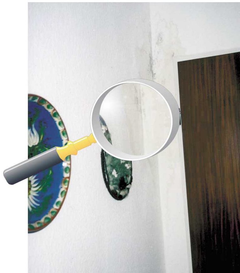
← Schaden unterm Flachdach. Deutlich sind in der Zimmerecke neben der Tür die Wasserspuren zu erkennen.
